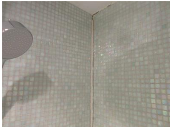
Lodrät spricka i innervägg i dusch
