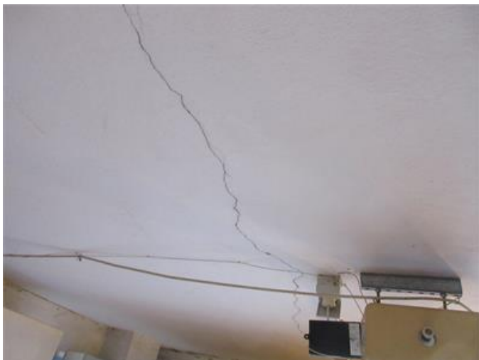
Spricka i garagetak
