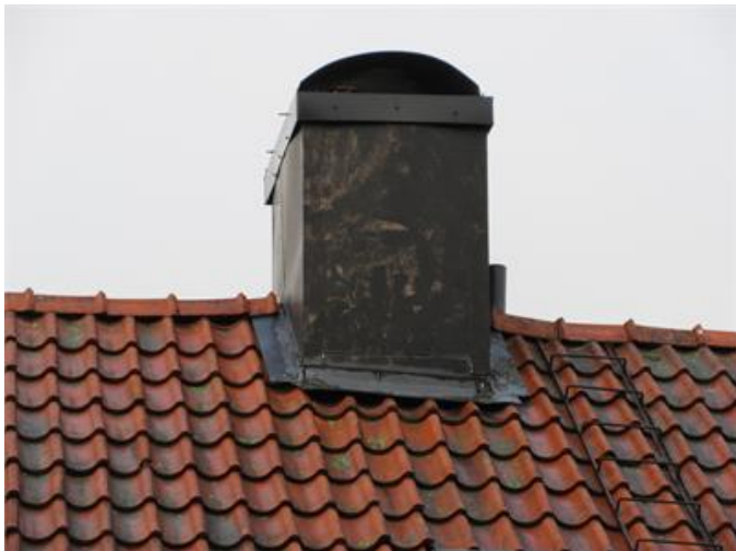
Äldre plåtarbeten på skorsten
