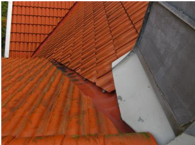
Läkt sticker ut under pannorna
