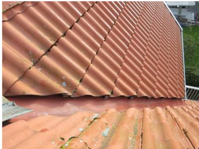
Läkt sticker ut under pannorna
