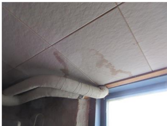
Missfärgningar i förrådstak källare
