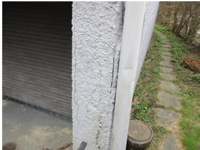
Sprickor i pelare
