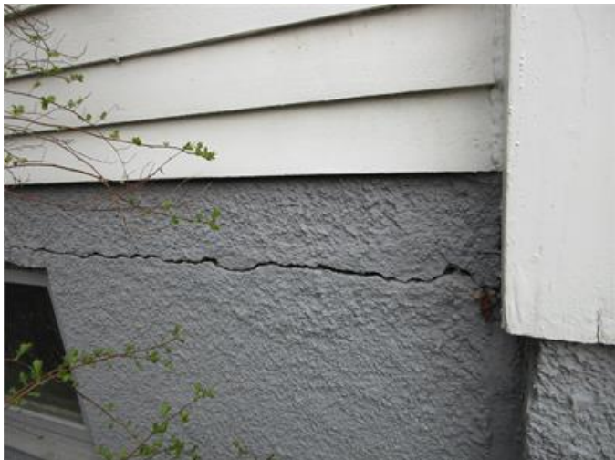
Spricka i sockel
