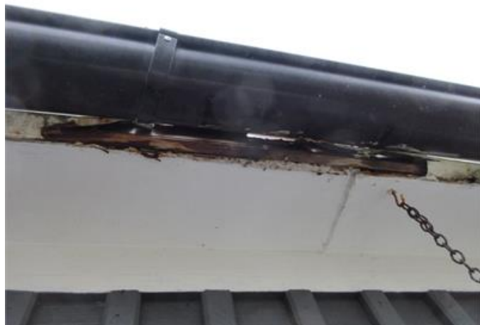
Röta i framkant takfot på balkong
