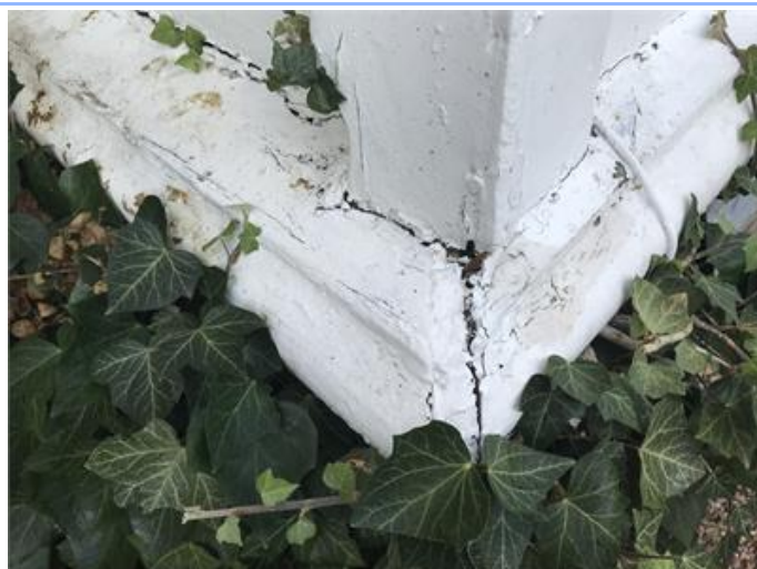
Fasadpanel/trädetaljer är bitvis i behov av målning/underhåll.
